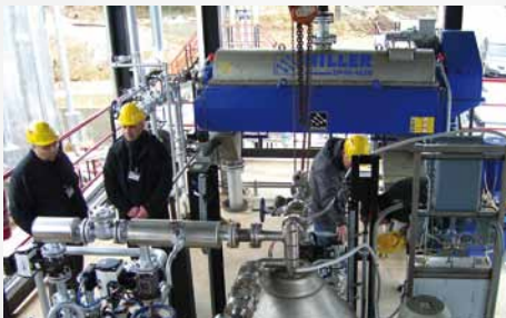
Trattamento fanghi oleosi in zona ATEX
