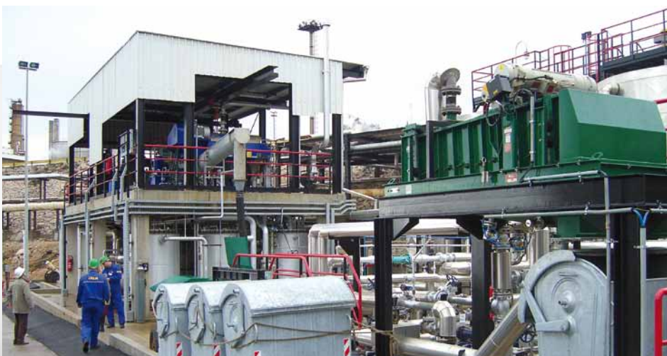
Impianto di trattamento in raffineria a prova di esplosione per fanghi oleosi
