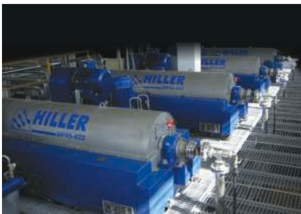
Statia de epurare a apelor reziduale, Mangalia
